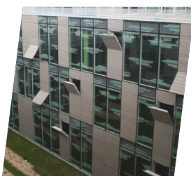
Désenfumage naturel & architectural
